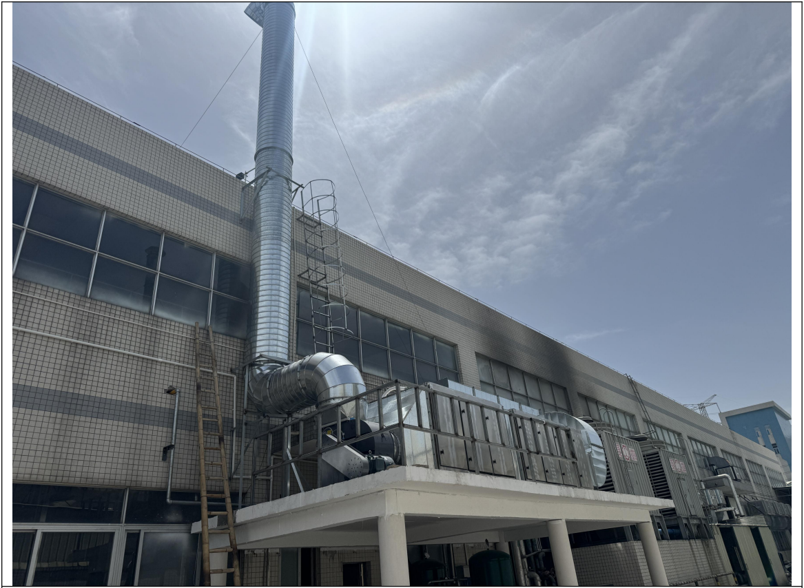
注塑废气处理设施 DA004
