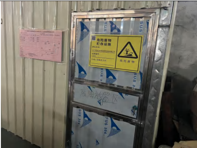
危废仓及标识牌
