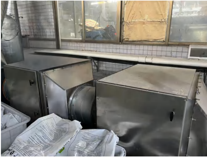
废气治理设施（二级活性炭）
