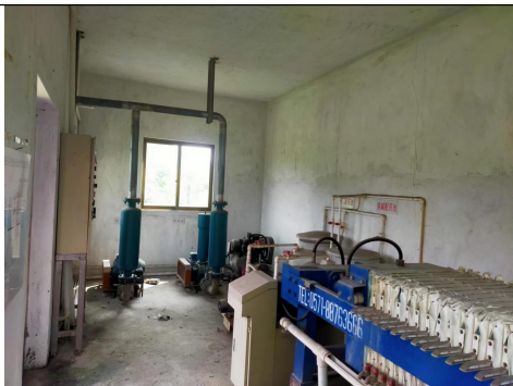
废水处理设施
