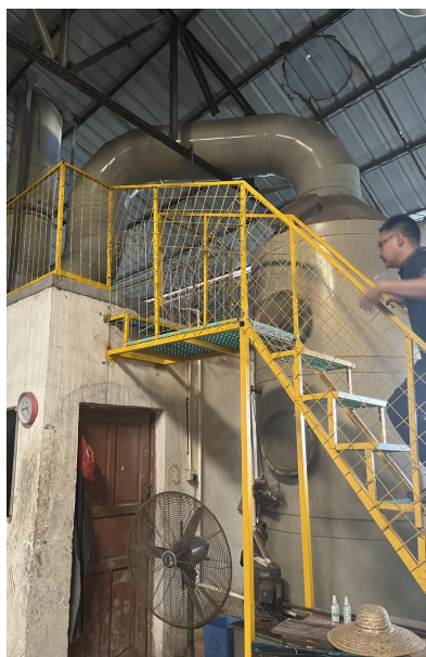
酸雾废气治理设施（碱液喷淋）
