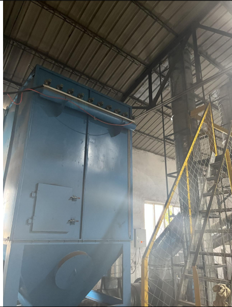
燃烧废气废气治理设施（旋风除尘器+布袋除尘器）
