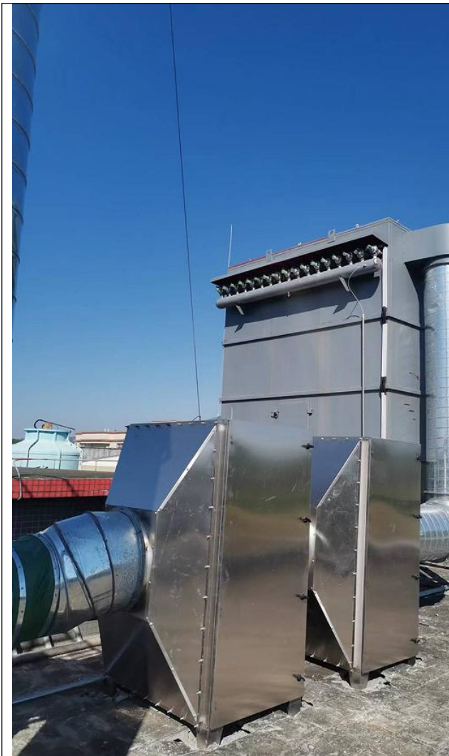
水性漆废气治理设施（脉冲布袋+二级活性炭）
