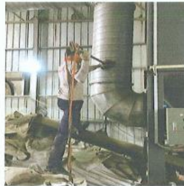
图2 输送、烘干、筛分废气排气管道采样口(处理前)
