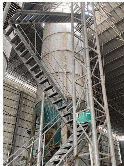
6、水稳生产线排气筒规范设置
