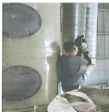
图4 沥青输送废气排气筒采样口(处理前)
