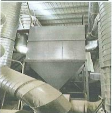
图7 输送、烘干、筛分废气处理设施: 脉冲除尘器
