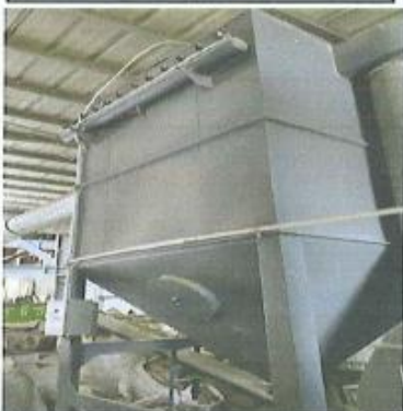
图8 废气沥青输送、天然气燃烧废气处理设施: 脉冲除尘器
