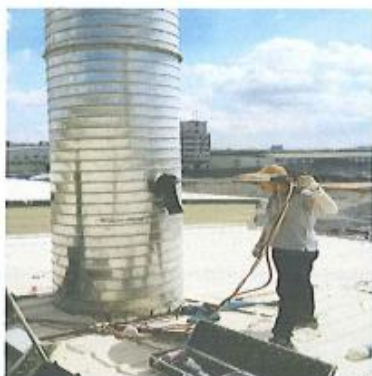
图3 输送、烘干、筛分废气排气筒采样口(处理后)①
