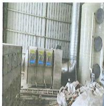
图10 废气处理设施： 水喷淋+静电除油+活性炭吸附
