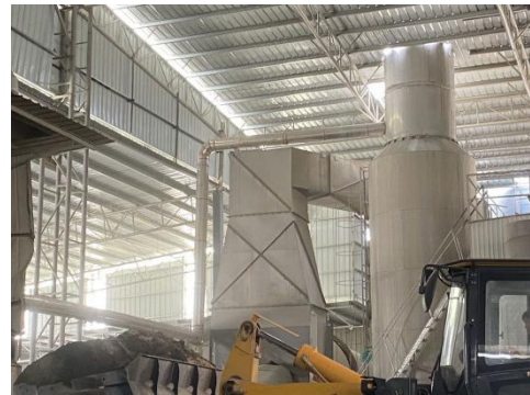
4、水喷淋处理及 P2 排气筒
