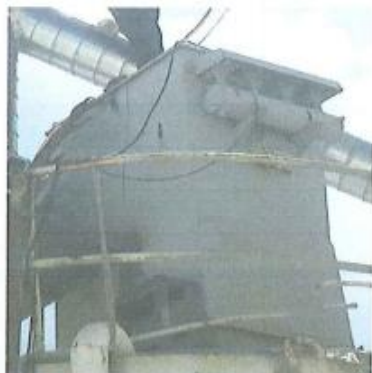
图9 水稳剂生产废气处理设施： 脉冲除尘器
