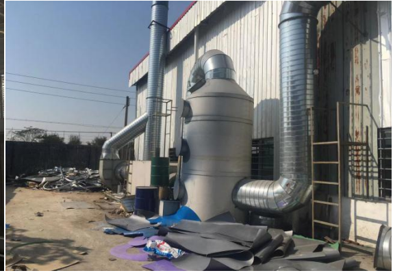
水喷淋+UV+活性炭吸附处理设施排气筒 G1
