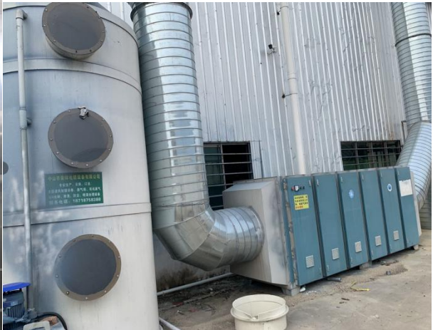
水喷淋+UV+活性炭吸附处理设施及排气筒 G2
