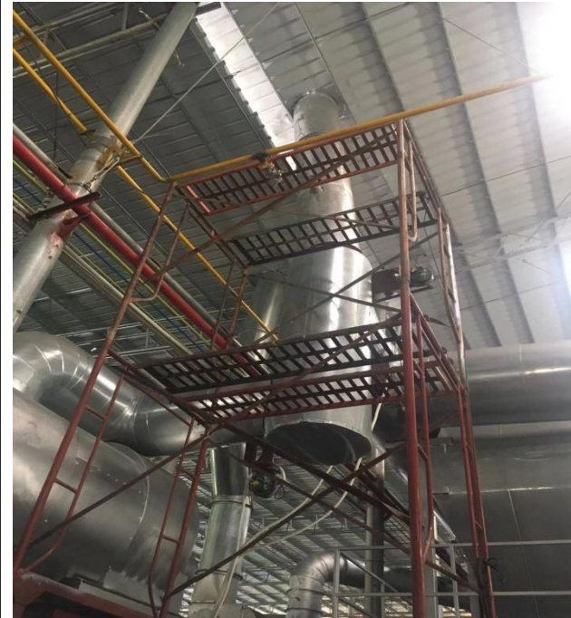
高温催化燃烧设施排气筒 G3
